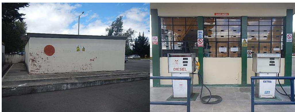
Figura 28 Estación de distribución de combustible en el CAL 9
