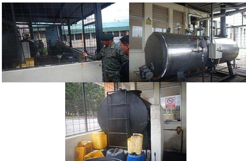
Figura 33 Caldero que utiliza diésel en el comedor
