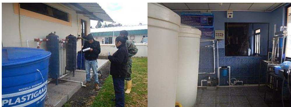
Figura 19 Planta de procesamiento de agua purificada
