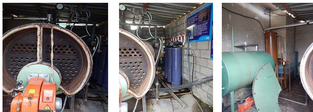
Figura 31 Calderos en mal estado en la piscina
