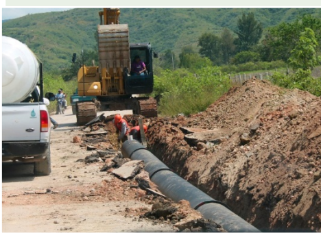
Alcantarillado y Saneamiento
