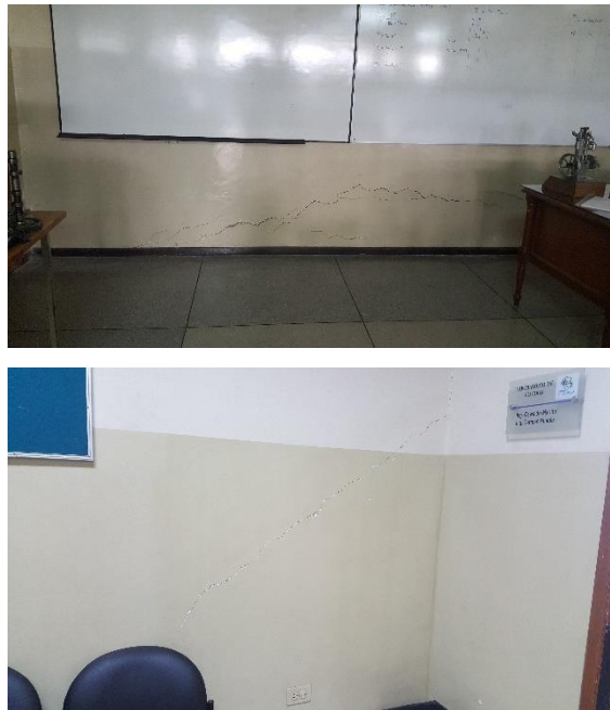
Figura 165 Agrietamientos en mampostería (EjeD)
