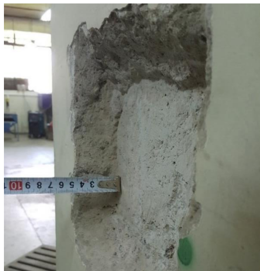
Figura 83 Superficie sin recubrimiento
