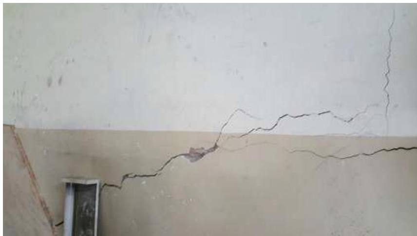
Figura 167 Agrietamiento en mampostería eje2
