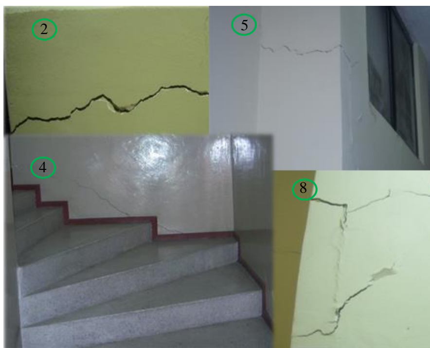
Figura 24 Grietas existentes en 2013
