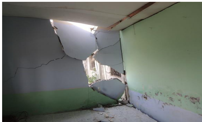
Figura 66. Agrietamiento y desprendimiento de mampostería en el sismo de Manabí de 2016.
