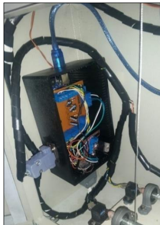
Figura 52. Controlador central acoplado a la estación.
