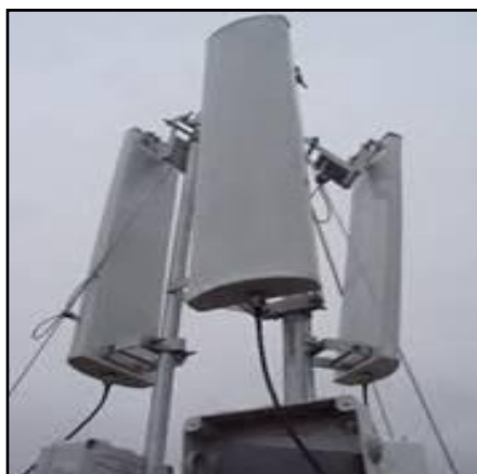
Figura 62 Arreglo Antenas Sectoriales Wifi
