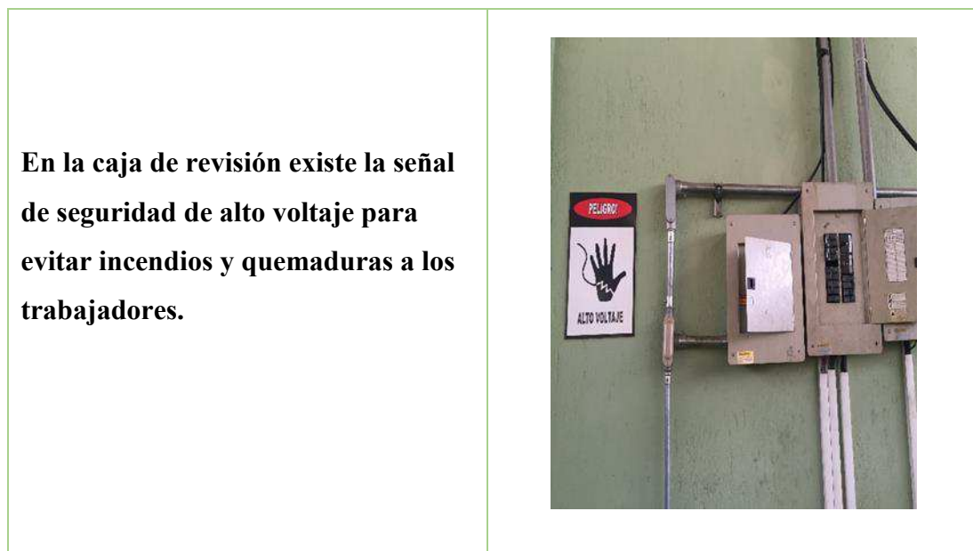
Figura 28 Sistemas de seguridad centro de mantenimiento material de transporte
