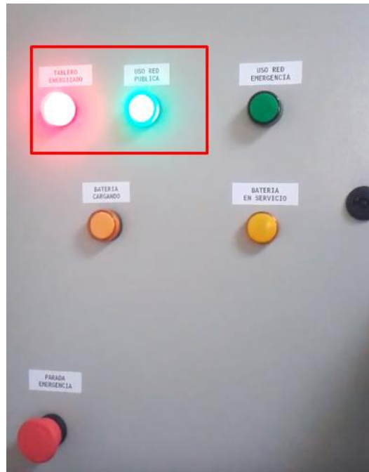
Figura 82. Red eléctrica en funcionamiento
