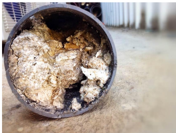
Figura 1 Tubo de PVC con residuos Fuente: (Hidrotec, 2016)
