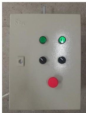
Figura 129 Puerta del tablero
