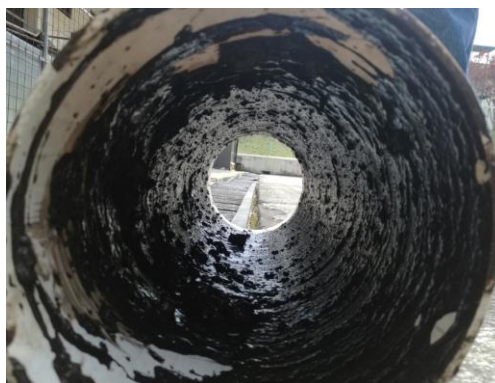
Figura 140 Suciedad inicial dentro de la tubería
