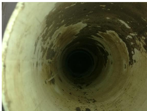
Figura 142 Resultados de la primera limpieza del robot dentro de la tubería
