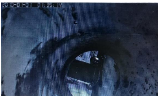
Figura 138 Inspección de tubería con sólidos
