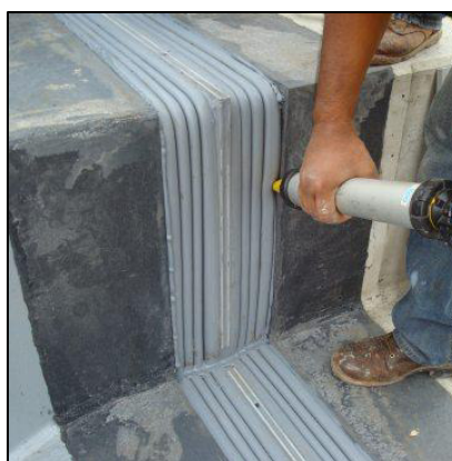
Figura 47 Sellamiento de Vacíos en la Junta por Medio de la Inyección de Silicona
