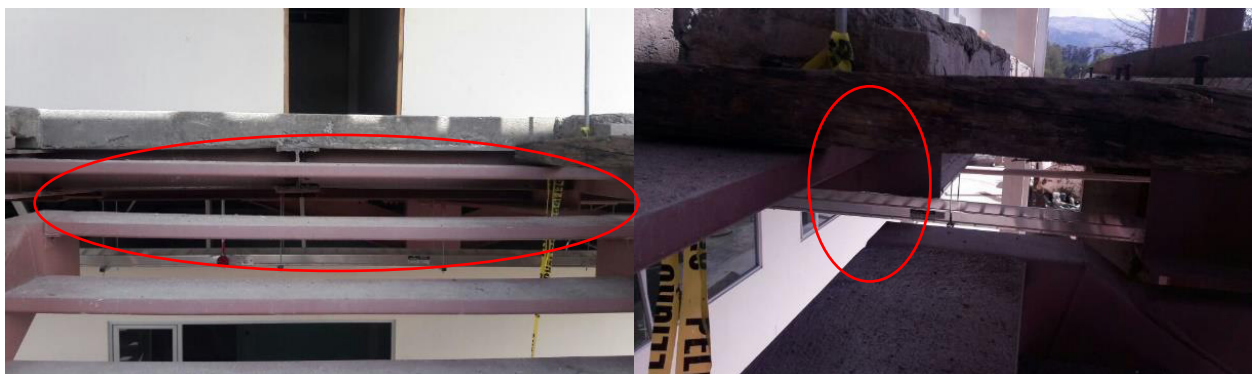
Figura 34 Juntas en Gradadas de Emergencia
