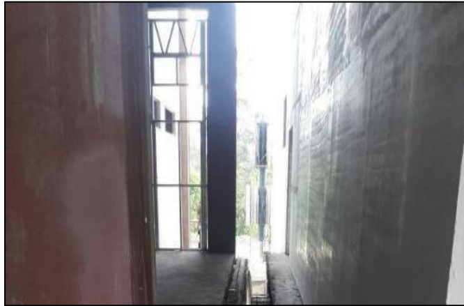
Figura 38 Juntas en Paredes
