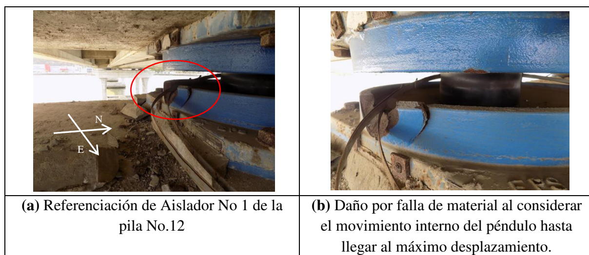
Figura 29 Evidencia de la dirección del sismo del 16 de Abril de 2016, de acuerdo al daño presentado en el Aislador No. 1
