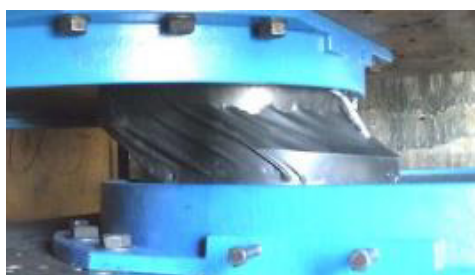
Figura 4 Acción deslizante de un aislador TPF deformado
