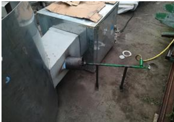
Figura 35 Adaptación del quemador
