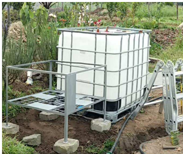
Figura 69. Soporte de bombas y electroválvulas.
