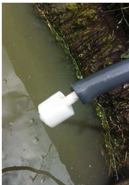
Figura 63. Ubicación del sensor de nivel en el reservorio
