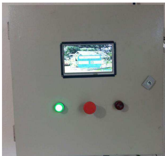
Figura 72. Vista fontral del tablero de control
