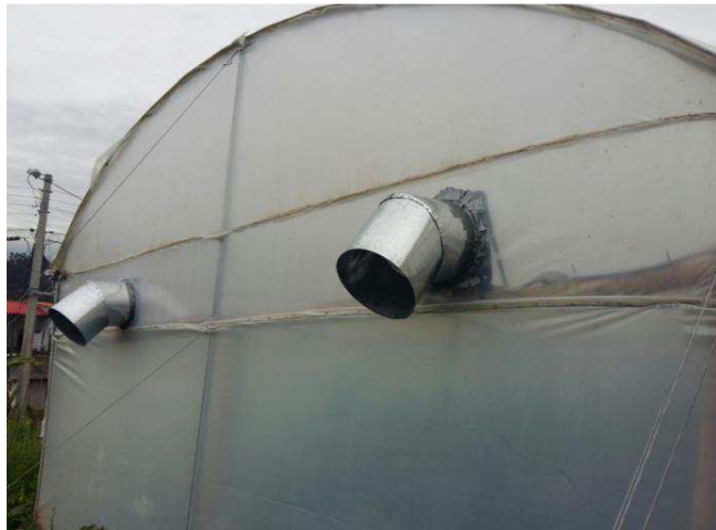
Figura 68. Extractores de aire
