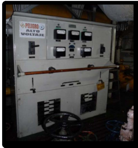
Figura 2.15 Tablero principal de la unidad Fuente: (Armada del Ecuador, 2013)
