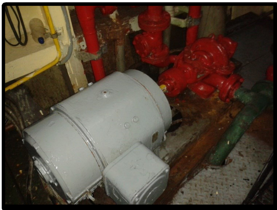
Figura 2.19 Bomba contra incendios
