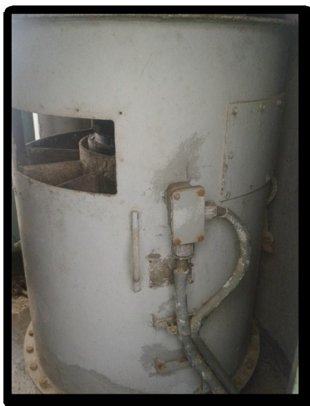
Figura 2.25 Motor de las ventilaciones Fuente: Buque Escuela Marañón Elaborado por: DAVID ANDRÉS DELGADO NÚÑEZ
