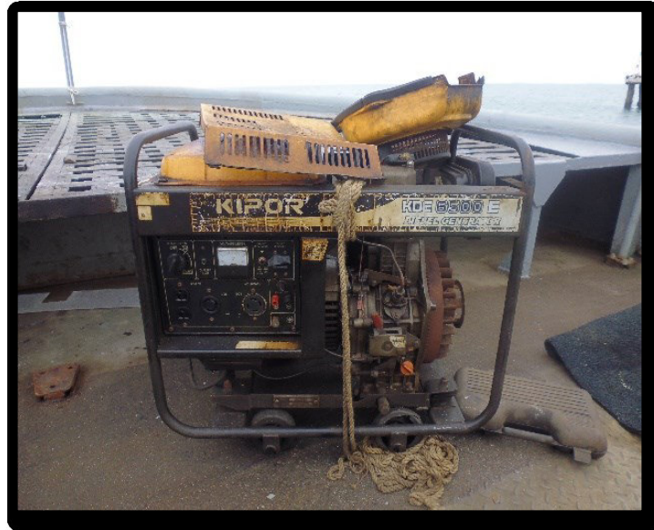
Figura 2.14 Generador auxiliar KIPOR Fuente: Buque Escuela Marañón Elaborado por: DAVID ANDRÉS DELGADO NÚÑEZ
