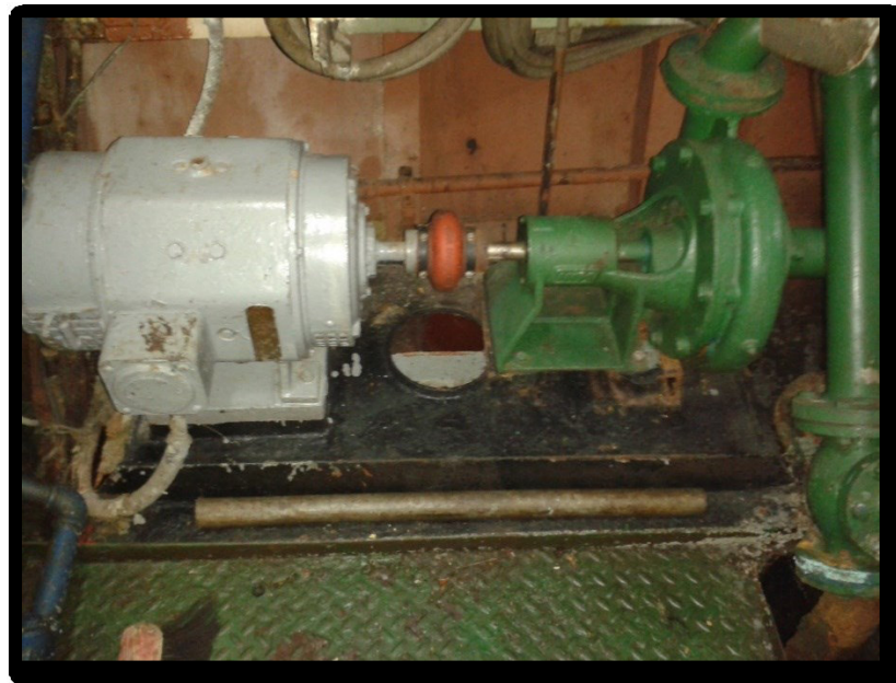
Figura 2.17 Bomba de agua salada
