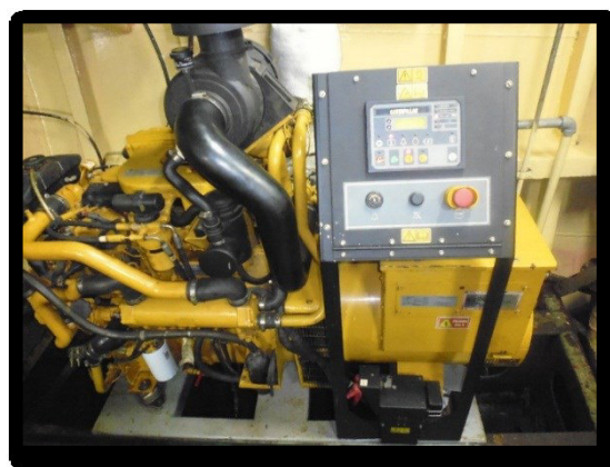
Figura 2.11 Motogenerador Caterpillar. Fuente: Buque Escuela Marañón Elaborado por: DAVID ANDRÉS DELGADO NÚÑEZ
