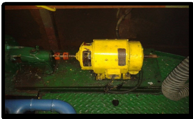
Figura 2.21 Bomba de achique
