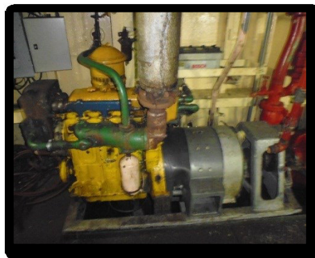
Figura 2.12 Generador DC GENERAL MOTORS Fuente: Buque Escuela Marañón Elaborado por: DAVID ANDRÉS DELGADO NÚÑEZ
