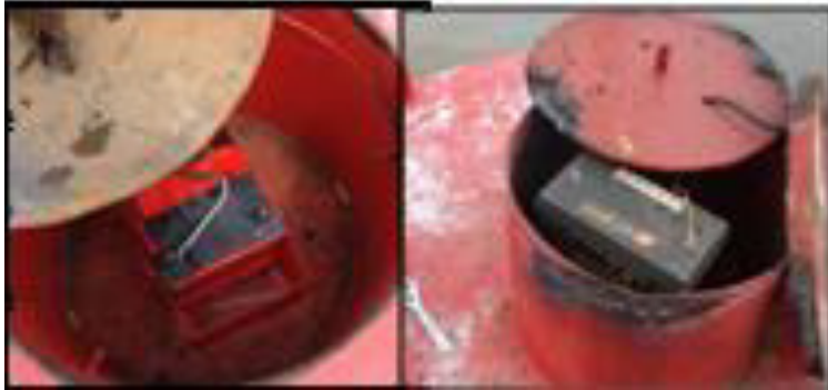
Figura 3.8 Baterías en cajas metálicas Fuente : INOCAR
