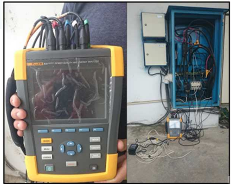
Figura 3.2.1: Equipo de medición FLUKE 435-II conectado en tablero de distribución del Bloque de Abastecimientos. Fuente: Remigio Haro
