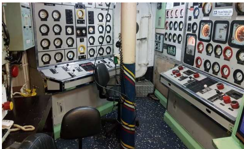
Figura 16. Sala de máquinas. Fuente. Luis Cadena Romero.
