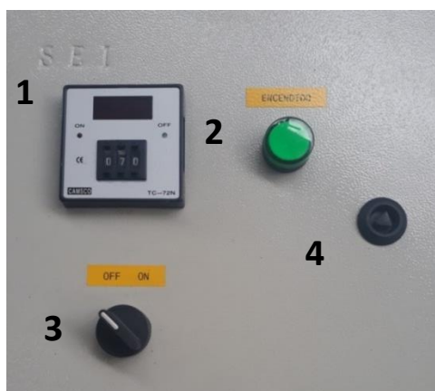
Figura 102. Exterior del gabinete de control
