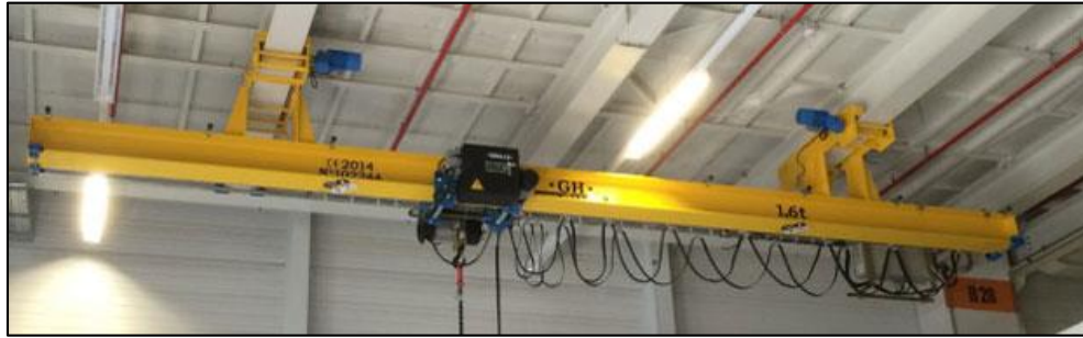
Figura 5. Grúa puente suspendida Fuente: (GH CRANES & COMPONENTS, 2018)
