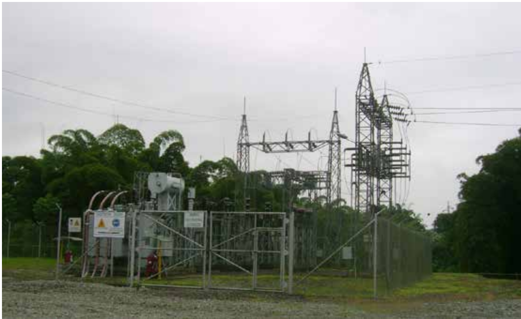
Figura 6.41 Subestación de la central hidroeléctrica Calope
