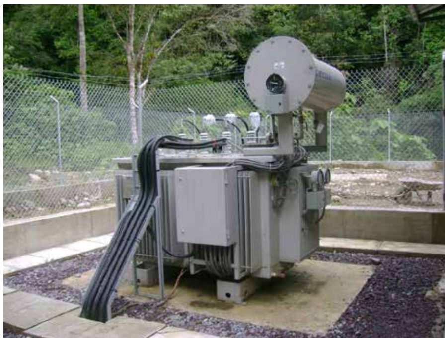
Figura 6.40 Transformador de una PCH
