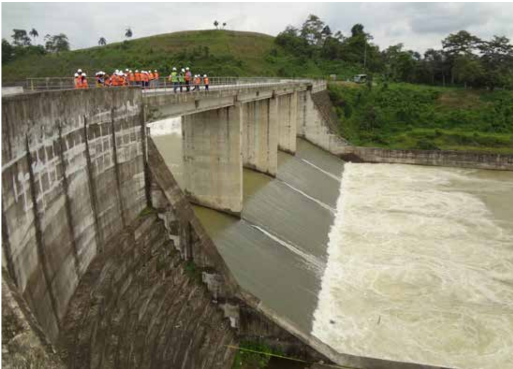
Figura 3.23 Vista de la sección de cierre y presa vertedora del proyecto Baba, Ecuador
