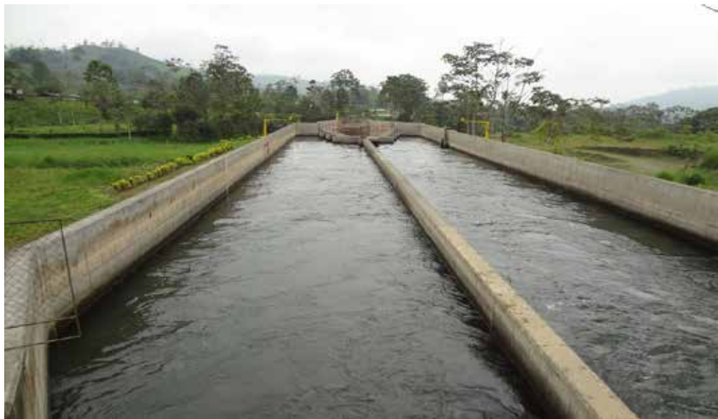
Figura 6.27 Desarenador de dos cámaras de la central del río Calope
