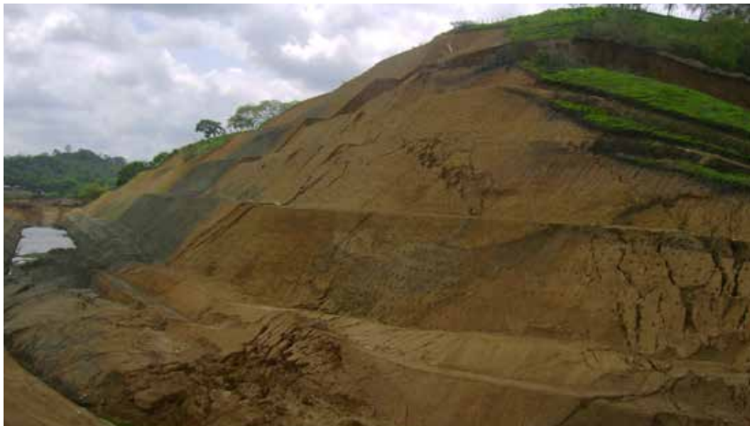
Figura 5.14 Deslizamiento del talud del canal del Proyecto MPC, Ecuador.
