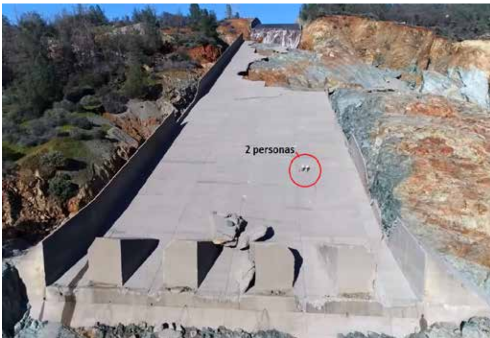
Figura 7.28 El aliviadero de la presa Oroville con daños graves.
