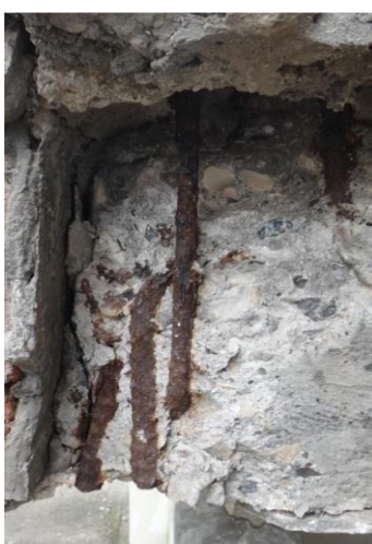
Figura 22. Oxidación de aceros en columna
