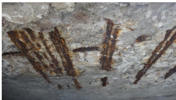
Figura 21. Oxidación de aceros en losa
