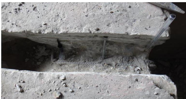
Figura 24. Desprendimiento manual de recubrimiento para comprobación visual de aceros
