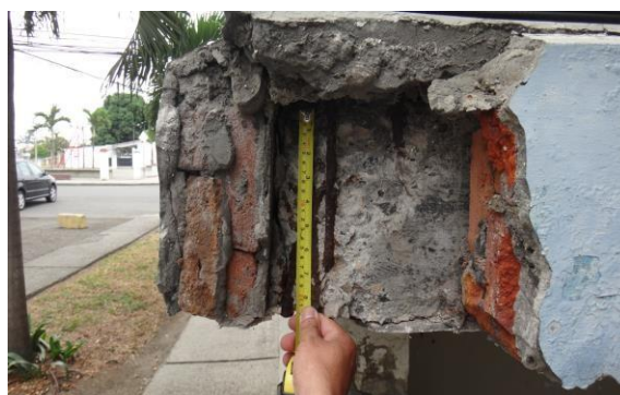
Figura 25. Discontinuidad en columna
