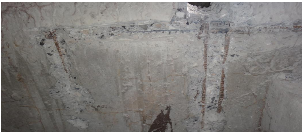
Figura 23. Exposición de aceros debido al poco recubrimiento en la losa
