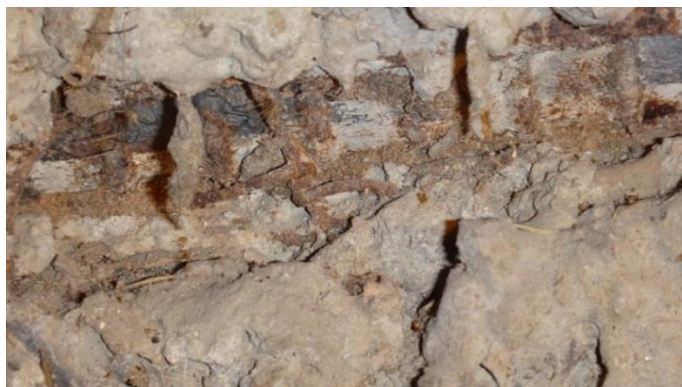
Figura 20. Oxidación de aceros en viga
