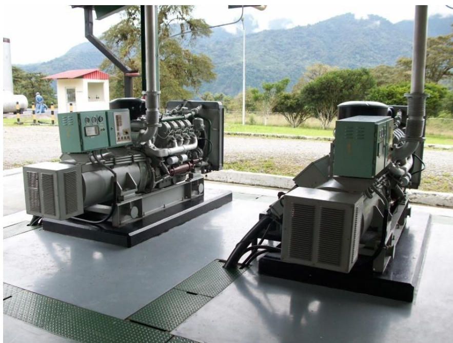
Figura. III.3. Ubicación de los generadores Estación OSAYACU
