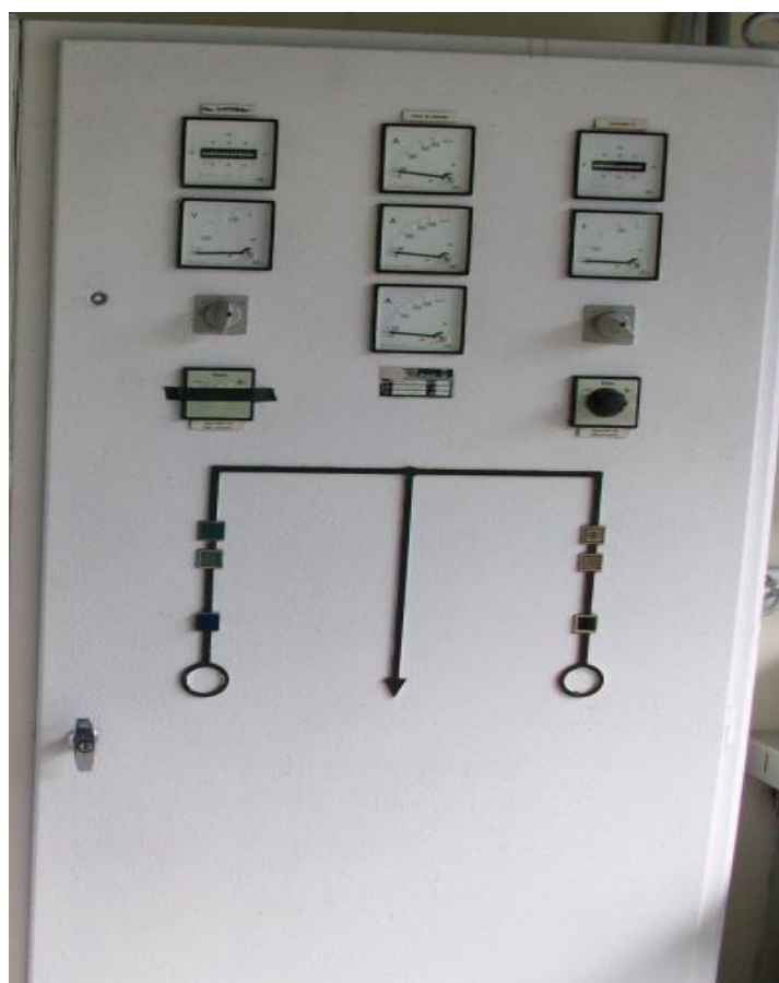
Figura. III.8. Armario de monitoreo de los generadores
