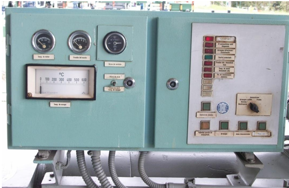
Figura. IV.2. Conjunto de control y monitoreo
