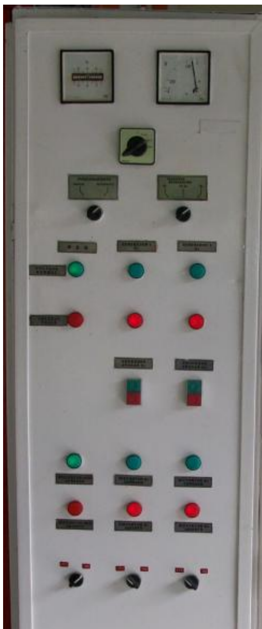
Figura. III.7. Armario de transferencia automática de energía (exterior)
