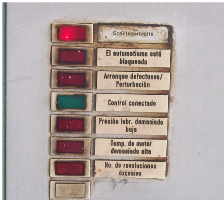
Figura. IV.6. Bloque de alarmas luminosas
