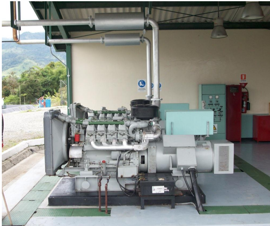
Figura. III.4. Vista lateral izquierda del generador
