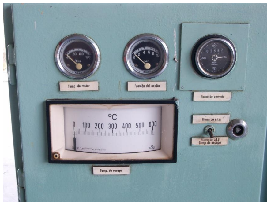
Figura. IV.8. Tablero de indicadores analógicos
