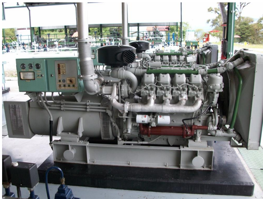
Figura. III.5. Vista lateral derecha del generador
