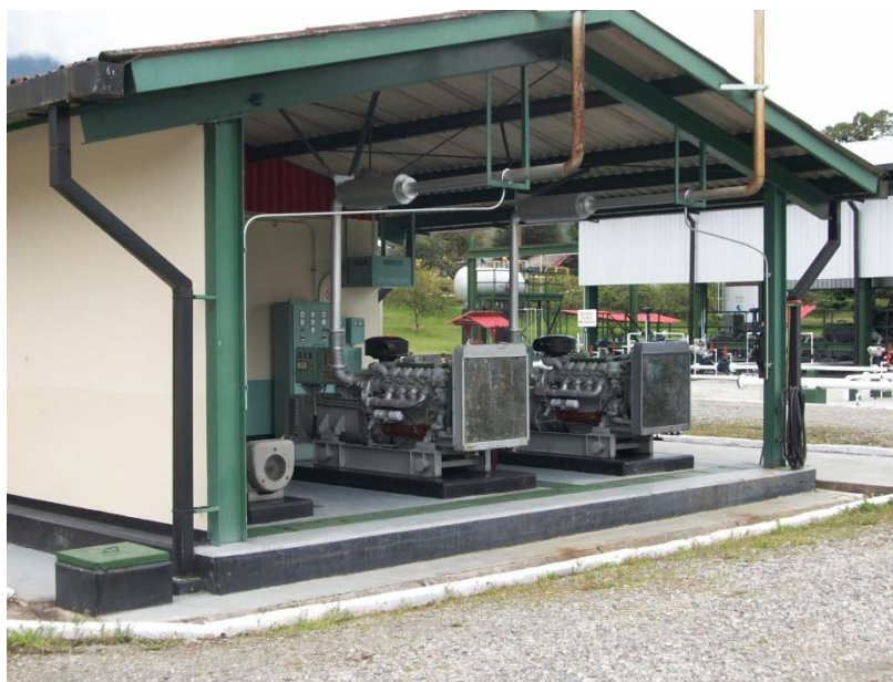
Figura. III.2. Cuarto de máquinas
