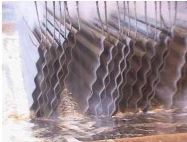
FOTOGRAFIA No. 1.4 Galvanizado
