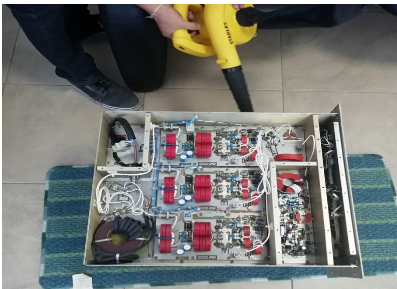
Figura 11 Limpieza de los bloques de acondicionamiento, pre amplificación y amplificador de potencia del sistema.
