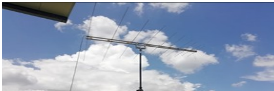
Figura 55 Antena de transmisión a 5,5m de altura, amplificador de 10 kHz – 100 MHz.
