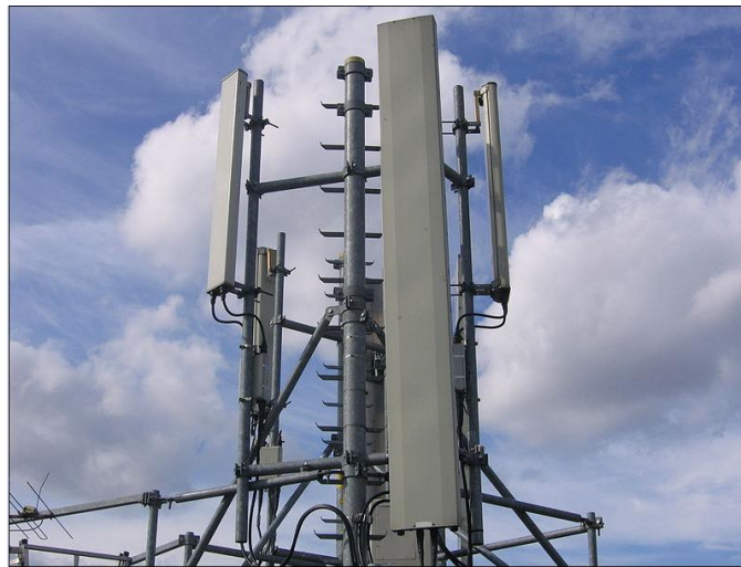
Figura. 1.6 Celda instalada en el techo de un edificio
