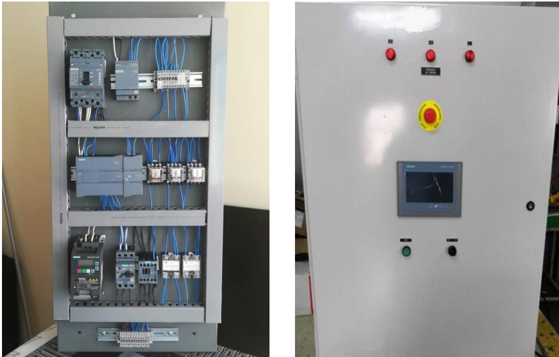
Figura 57. Tablero de control
