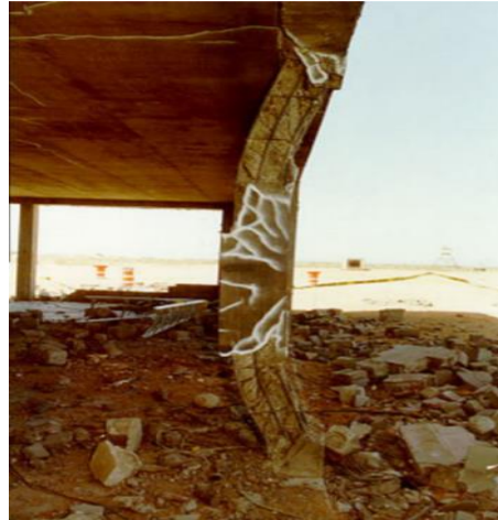
Figura 3. Deformación en columna de hormigón armado causada por detonación
