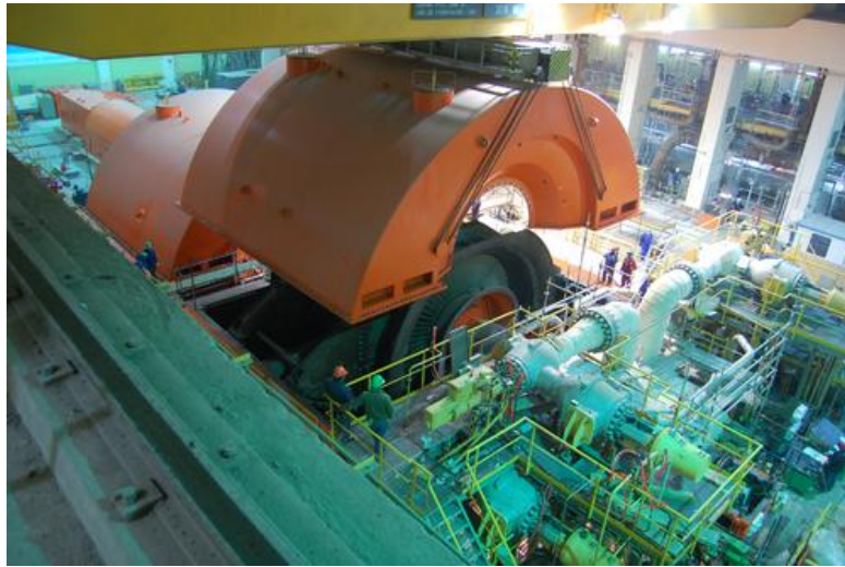
Figura 103. Central térmica Aberthawm 100MW, con entrada de vapor a 100 bar, 524 °C (Sánchez A. , 2018)
