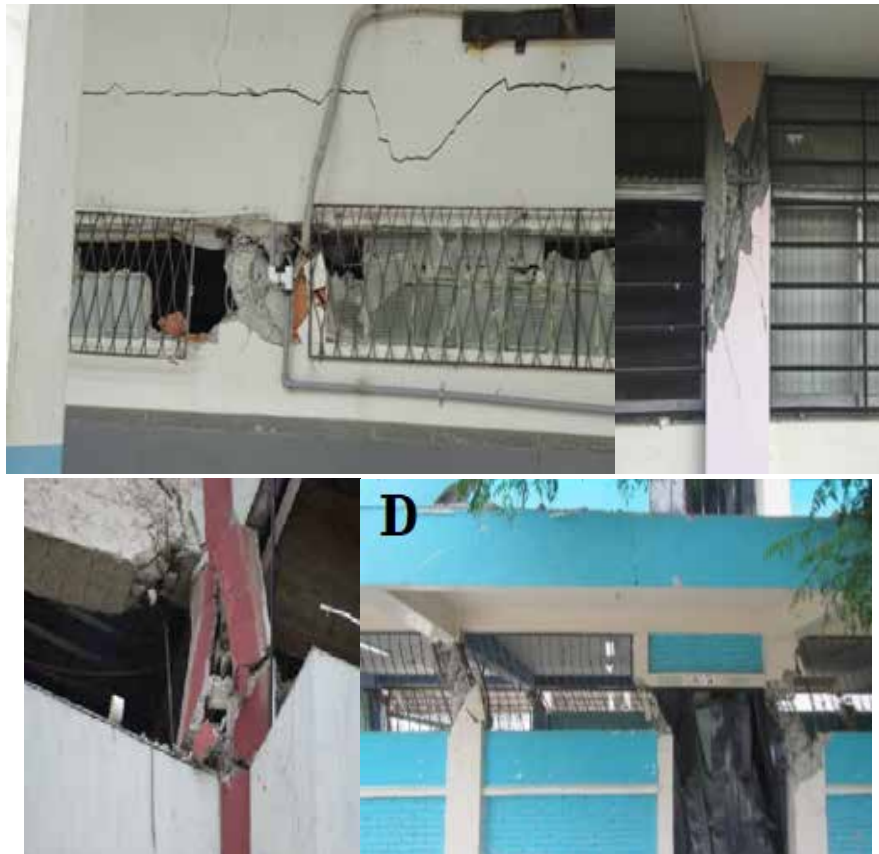
Figura TA6.1: Columna corta, falla por cortante (Fuente: varias, sismo de Pedernales 2016)
