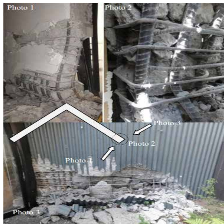
Figura 4.4. Daño en muros en Christchurch luego del sismo de 02-22-2011 Fuente: Modelos para calcular pandeo local en muros estructurales de hormigón armado (Haro, 2015)
