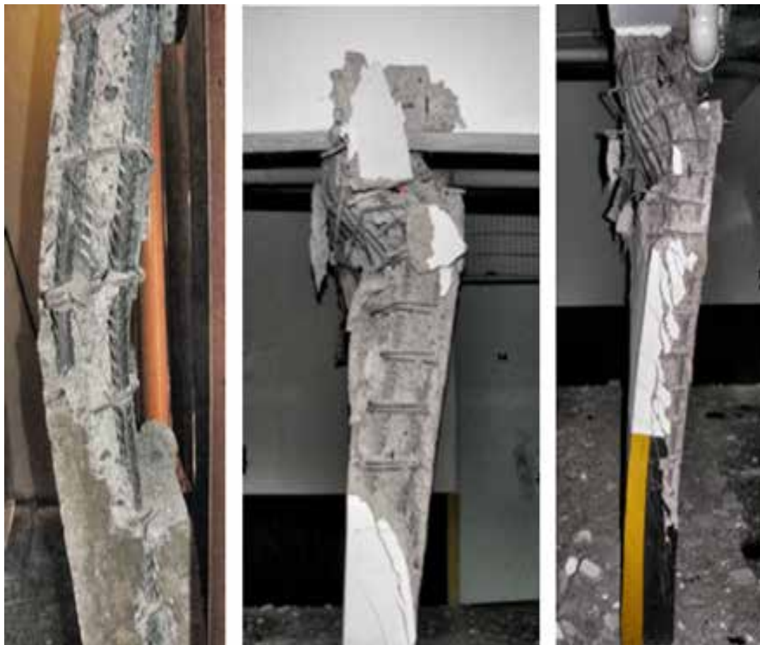
Figura 4.3. Daño en muros en Chile luego del sismo de 02-27-2010
