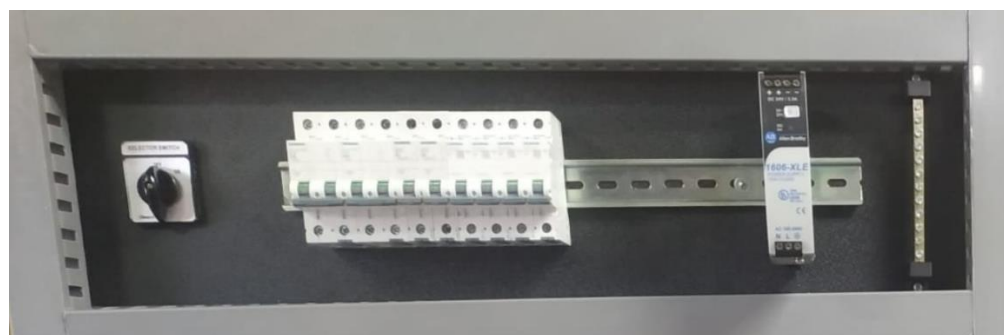
Figura 48. Implementación del Rack 1
