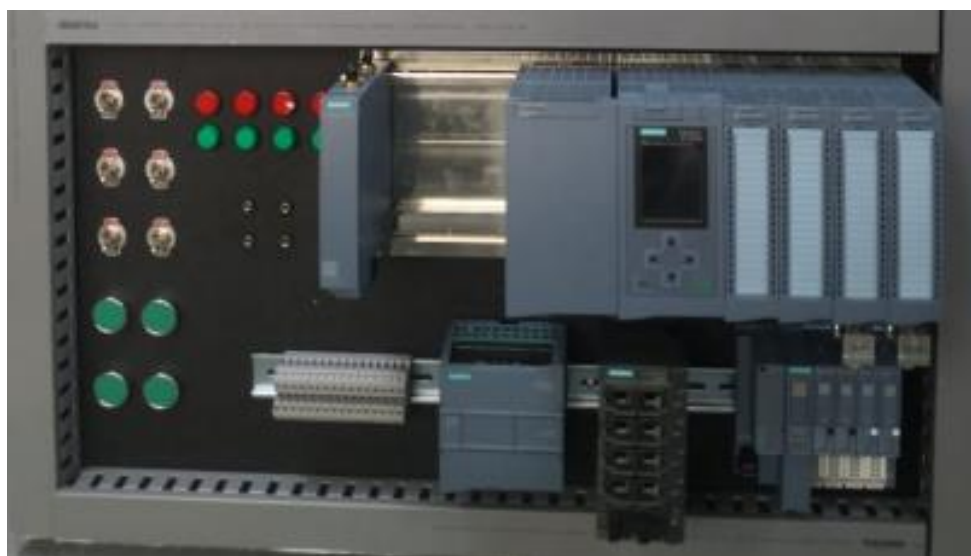
Figura 50. Implementación de Rack 3
