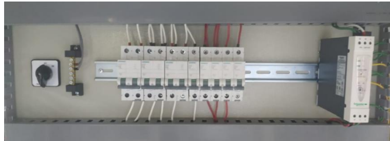
Figura 51. Implementación del Rack 1 del Sistema de Entrenamiento de PLC
