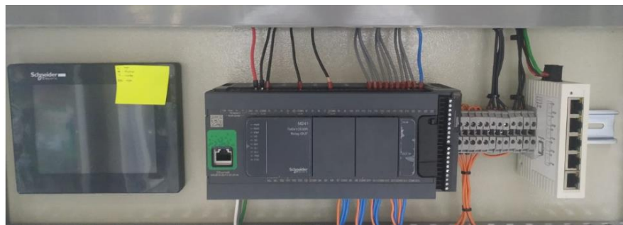
Figura 52. Implementación del Rack 2 del Sistema de Entrenamiento de PLC
