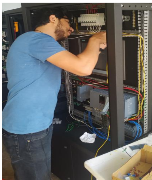
Figura 55. Conexión entre Protecciones y Equipos de control
