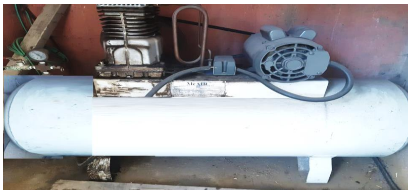
Figura 51. Compresor de las instalaciones del laboratorio.
