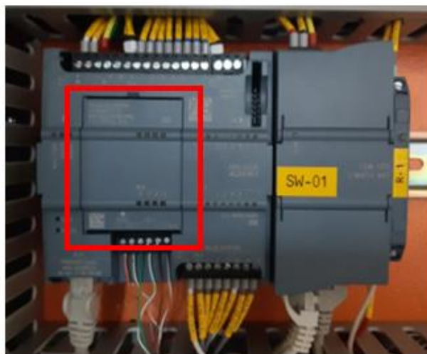
Figura 126. Implementación del módulo al PLC.
