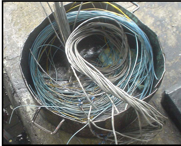
Figura 6.18. Exceso de cable retirado del grupo de bombeo P – 301
