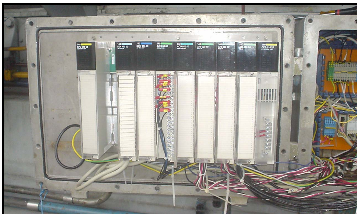
Figura 6.22. PLC del grupo de bombeo P – 301
