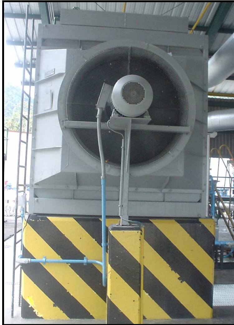
Figura 2.8. Radiador del grupo P – 303
