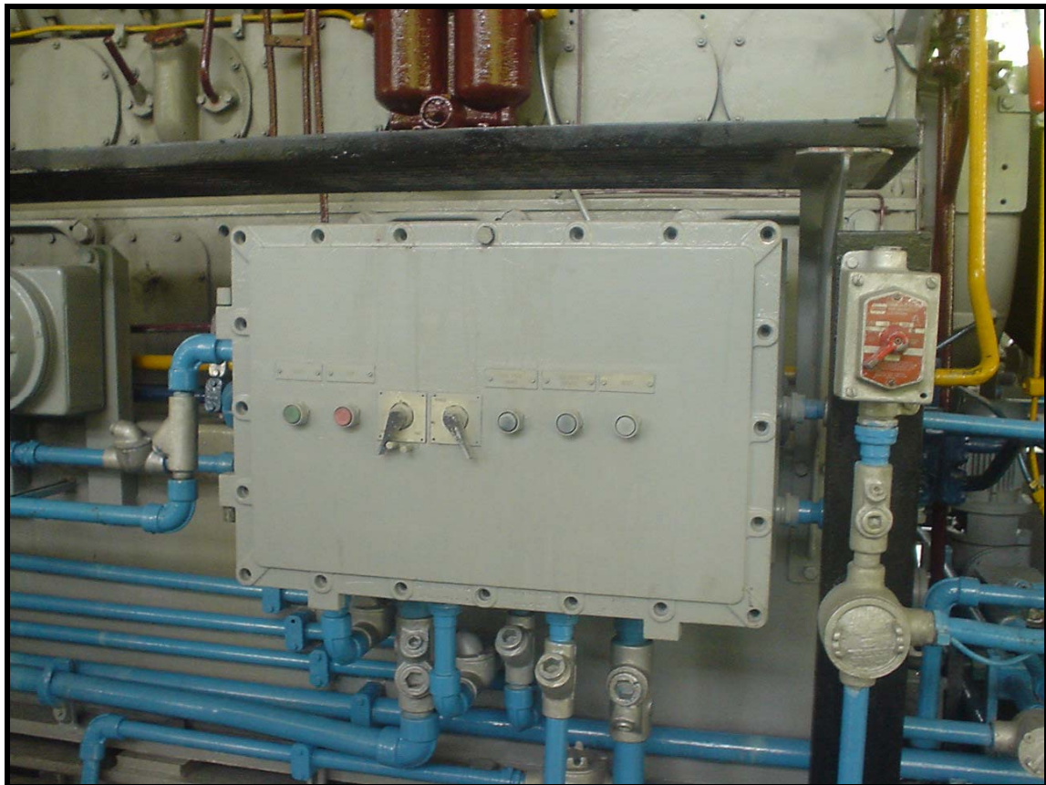
Figura 6.8. Caja explosion-proof del grupo de bombeo P – 301
