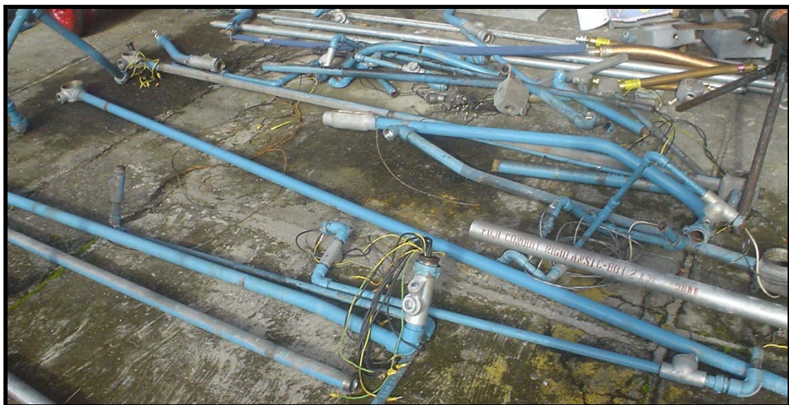
Figura 6.19. Tubería que contenía cables de conexión en el grupo de bombeo P – 301
