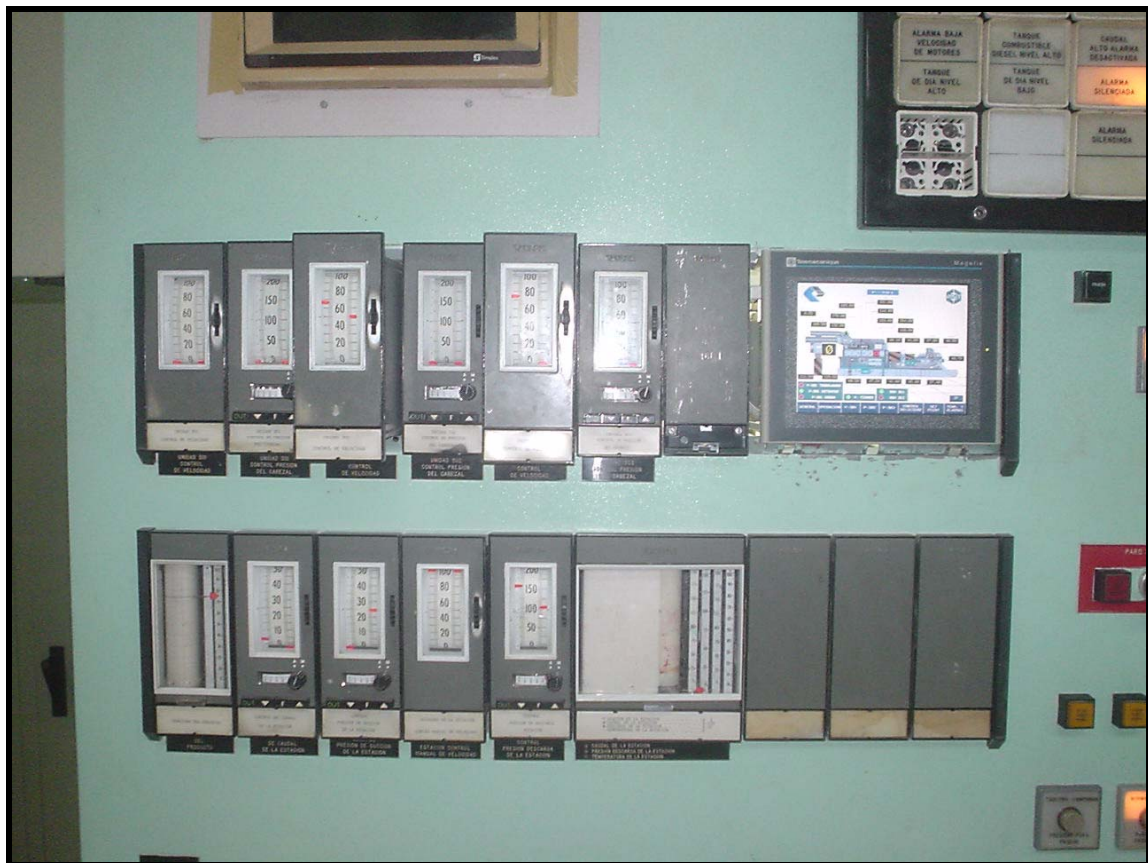
Figura 6.32. Interfaz de operador en el tablero de control antiguo
