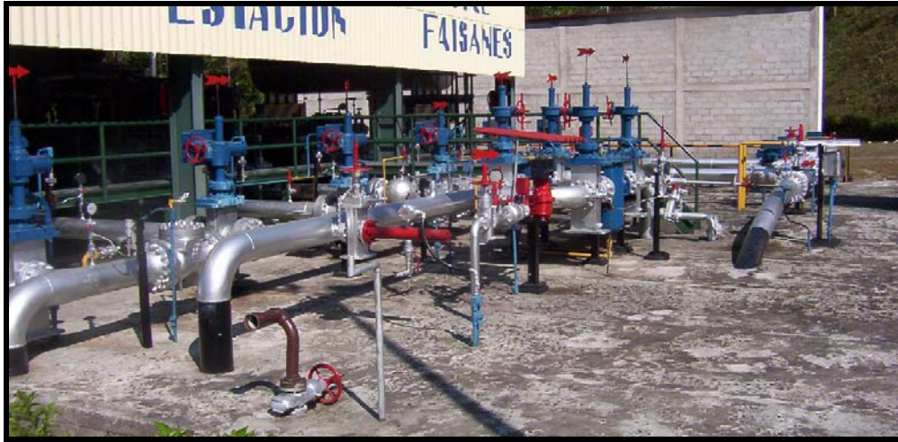
Figura 2.1. Tuberías auxiliares y válvulas de la estación Faisanes
