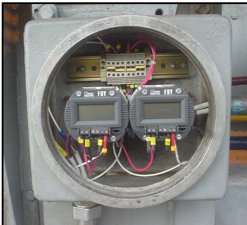
Figura 6.24. Transductores de velocidad ubicados en una caja explosion-proof
