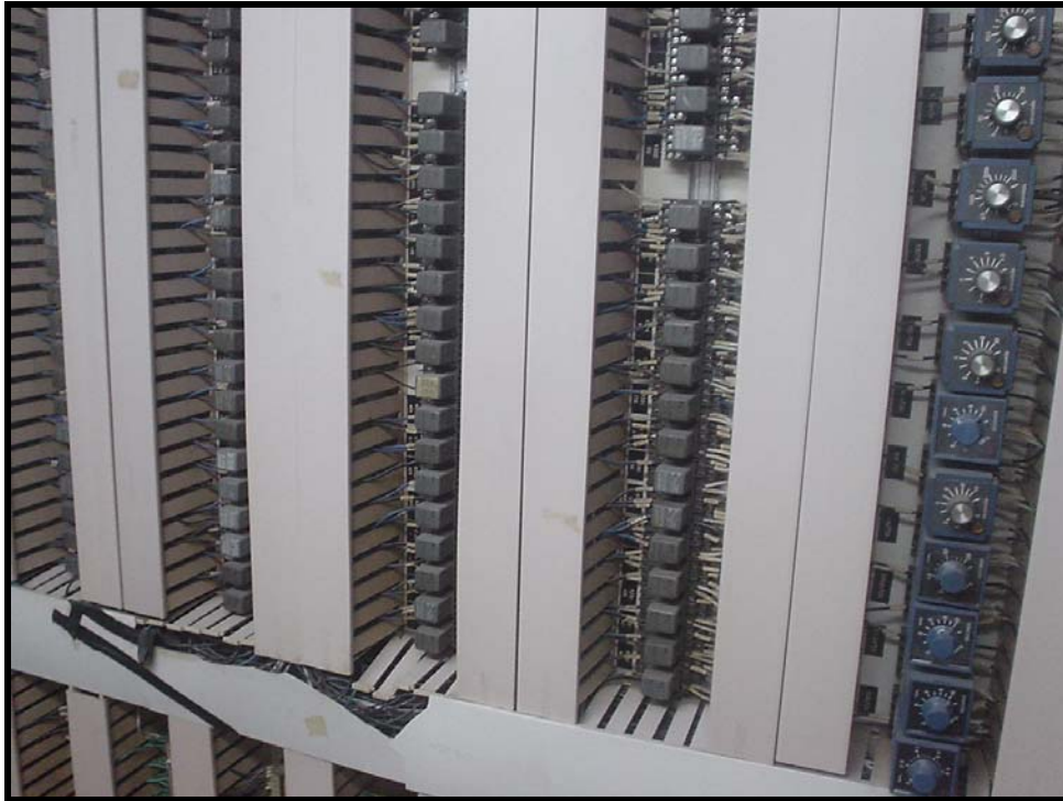
Figura 2.11. Relés ubicados en el interior del tablero de control
