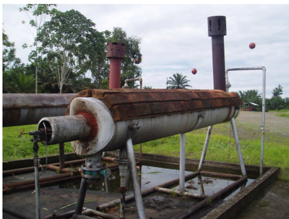
Figura 1.1 Sistema actual de calentamiento (fuera de servicio)
