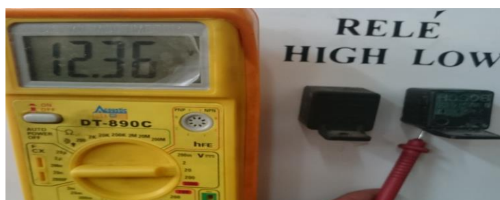
Figura 83 Voltaje en el relé que activa electro ventilador
