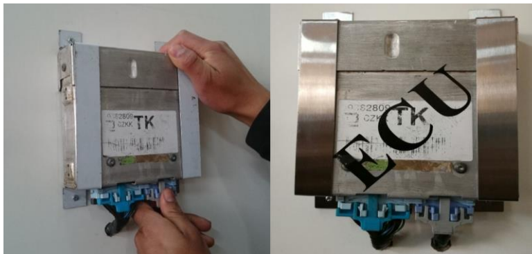
Figura 41 Ubicación de la unidad de control en el tablero
