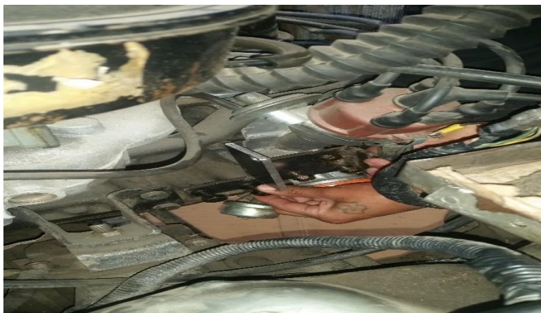
Figura 58 Instalación del compresor
