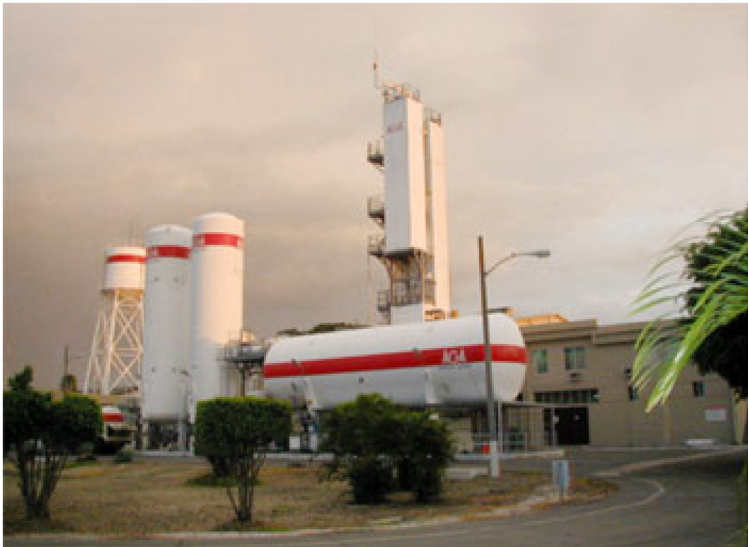
Vista de la Planta de Gases localizado en Guayaquil - Ecuador
