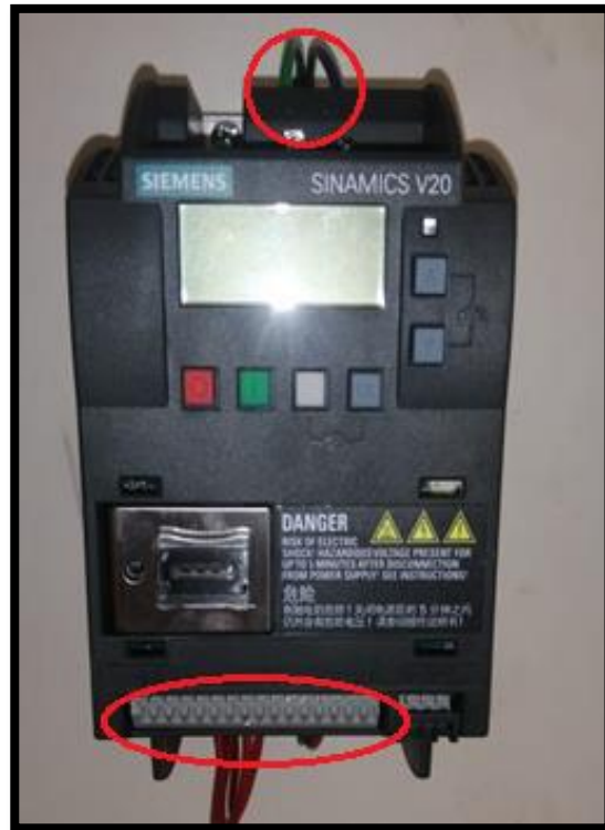
Figura 35. Cableado de variador de frecuencia.
