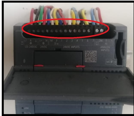
Figura 34. Cableado de PLC
