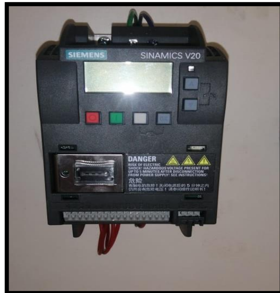
Figura 47. Variador de frecuencia.
