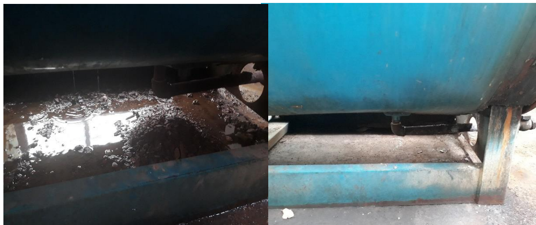
Figura 19. Mantenimiento en las fugas existentes del caldero.
