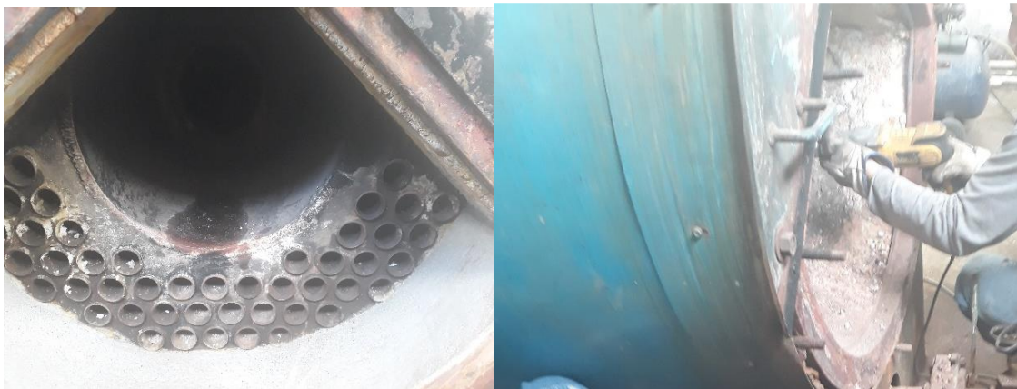
Figura 18. Mantenimiento tubos de fuego
