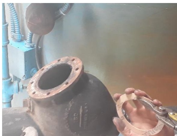
Figura 21. Mantenimiento del MCDONELL
