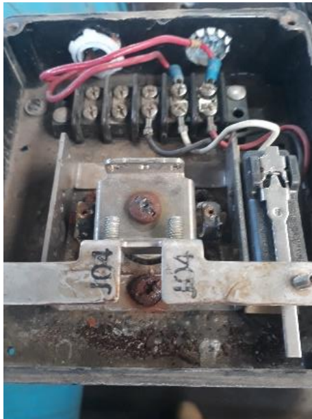
Figura 9: Switch encargado del control de la bomba de agua
