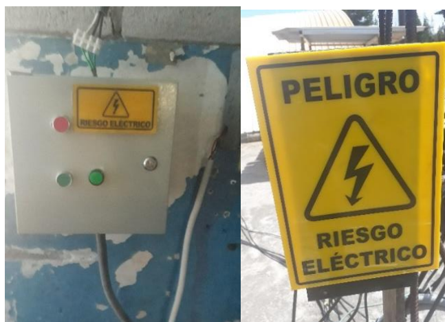
Figura 27: Señalización de equipos e instalaciones eléctricas
