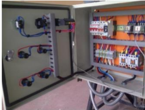
Figura 10. Tablero de control
