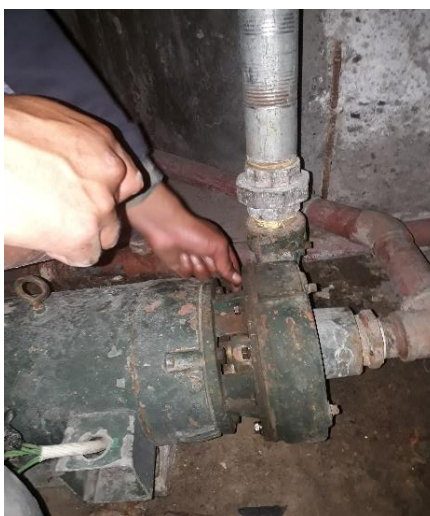
Figura 16. Bomba Baldor Electric de 15 hp
