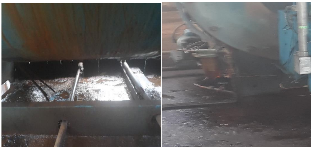
Figura 14. Fugas de agua y combustible en el caldero
