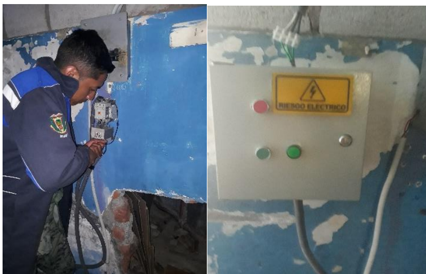
Figura 26. Mantenimiento del sistema eléctrico y de control de la bomba
