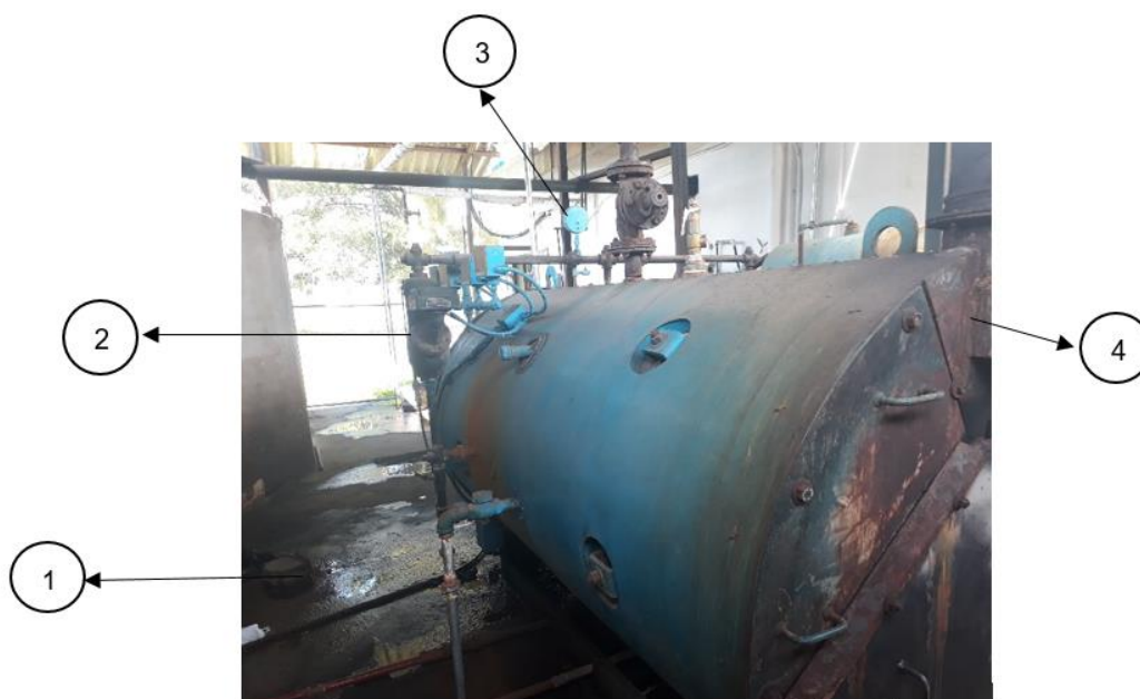
Figura 13. Foto del caldero previo a la repotenciación
