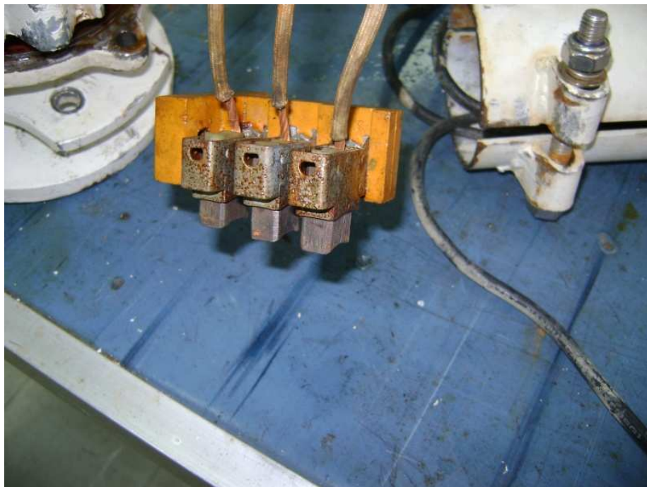
Foto 3.3 Porta escobilla con escobillas oxidadas
