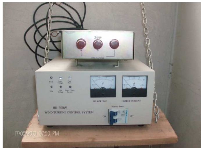
Foto 3.15 Controlador de voltaje, corriente y resistencia de carga
