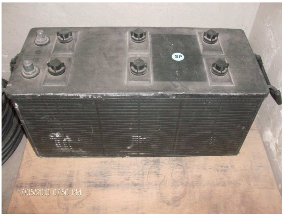
Foto 3.25 Ubicación de la batería solar
