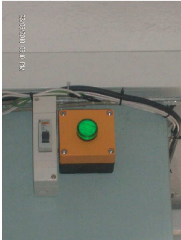
Foto 3.18 Breaker y foco de señalización
