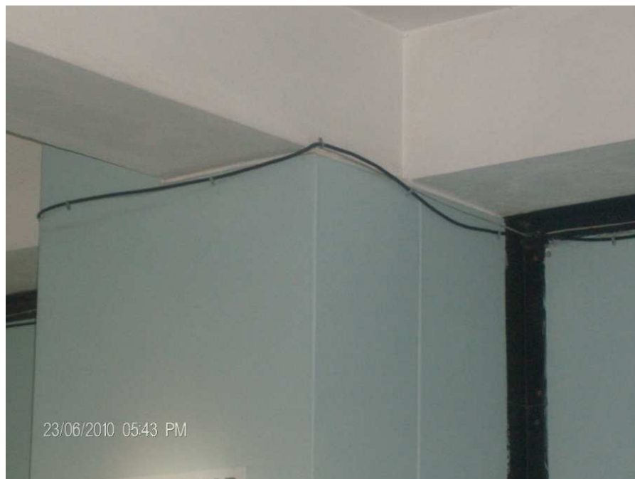
Foto 3.34 Cableado que va del breaker a la otra puerta automática ITSA
