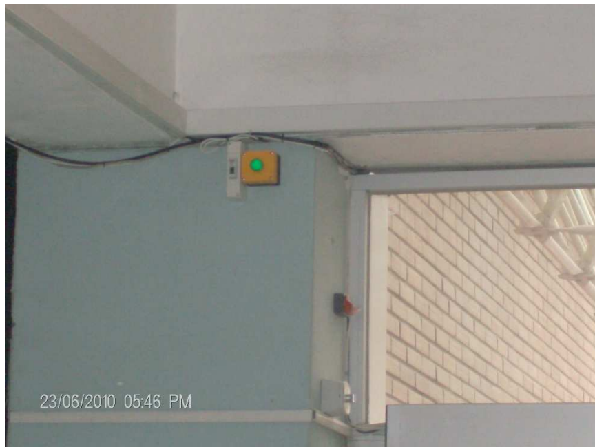
Foto 3.32 Cableado que baja de la terraza del ITSA al breaker que está en planta baja, parte superior izquierda de la puerta de ingreso del Instituto
