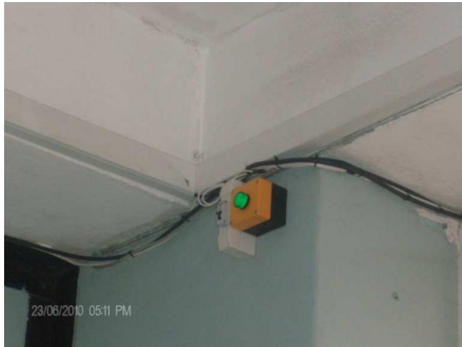
Foto 3.36 Cableado que baja de la terraza del ITSA al breaker que está en planta baja, parte superior izquierda de la puerta de ingreso del Instituto
