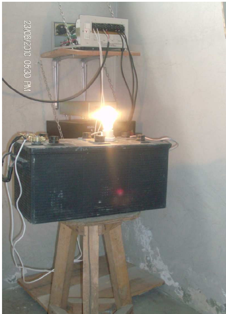
Foto 3.28 Primera energía eólica producida por el aerogenerador
