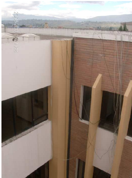
Foto 3.30 Cableado que baja de la terraza del ITSA
