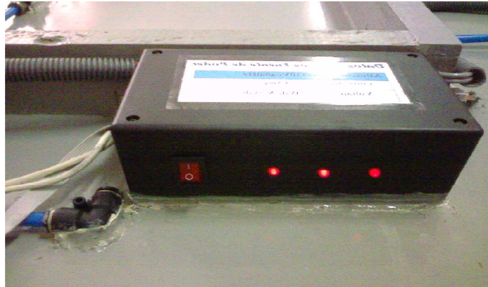
Foto 35. Fuente de poder en funcionamiento
