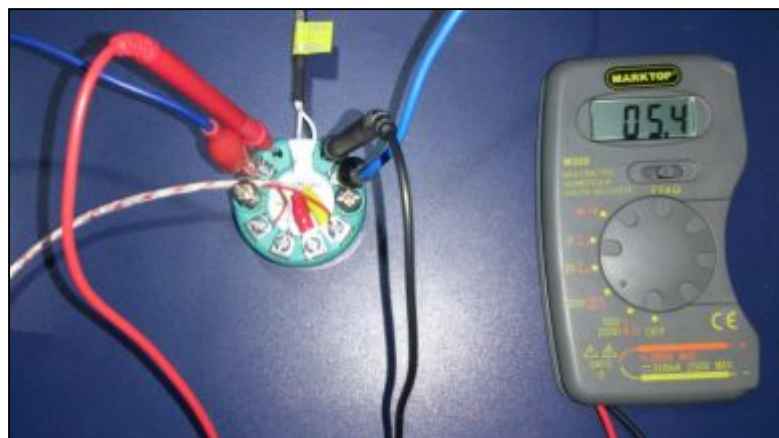
Figura 754.- Lectura con el multímetro de termocupla y PT100 Fuente.- SIEMENS
