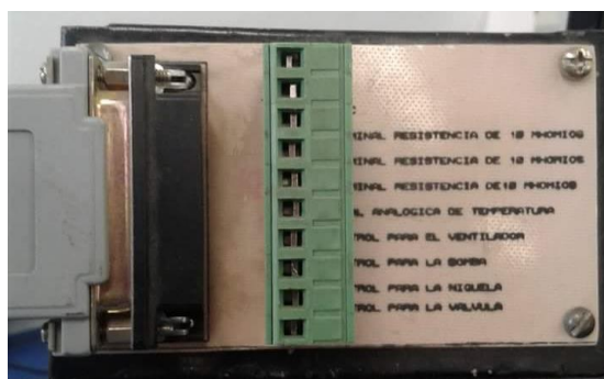
Figura 27 Borneras de conexión
