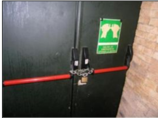
Figura 11 Prohibición de cerradura de puertas de emergencia Fuente (Acosta, 2007)
