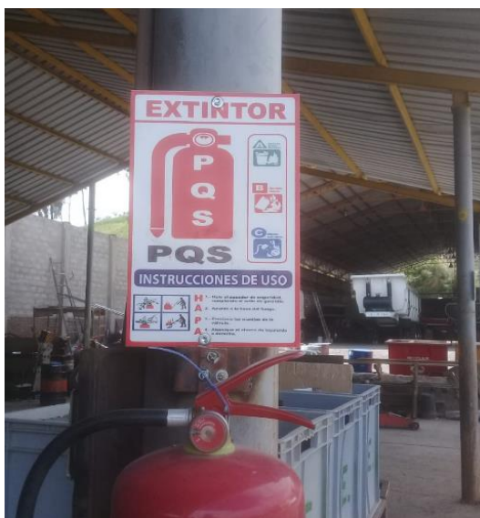
Figura 30 Reubicación de extintores Fuente: Investigación de campo
