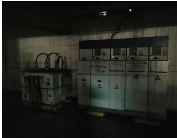
Figura 32. Cámara de control y transformador
