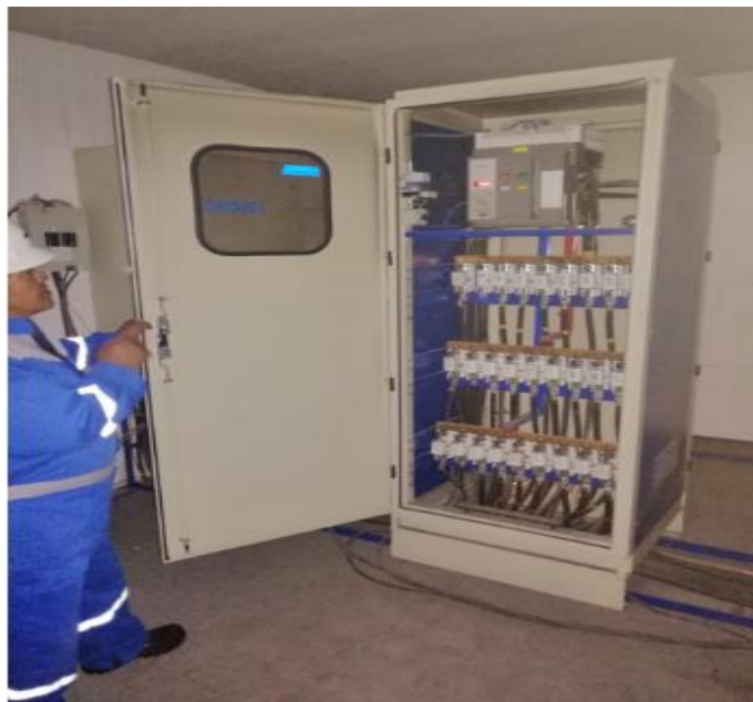
Figura 31. Cámara de seccionadores y fusibles
