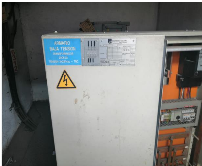
Figura 27. Tablero de baja tensión
