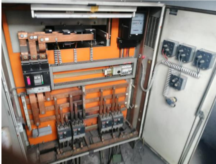
Figura 28. Armario de Baja tensión
