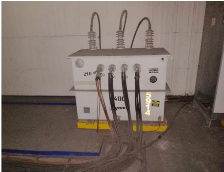
Figura 33. Transformador de baja tensión.
