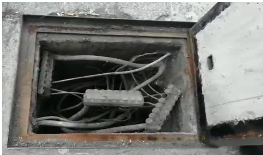
Figura 29. Cajas de revisión de terminales eléctricos estandarizada
