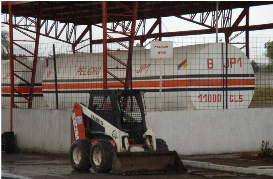
Figura 1 Aquí se observa la falta de señalización que existe en el reservorio del combustible aéreo, tan solo existe una.
