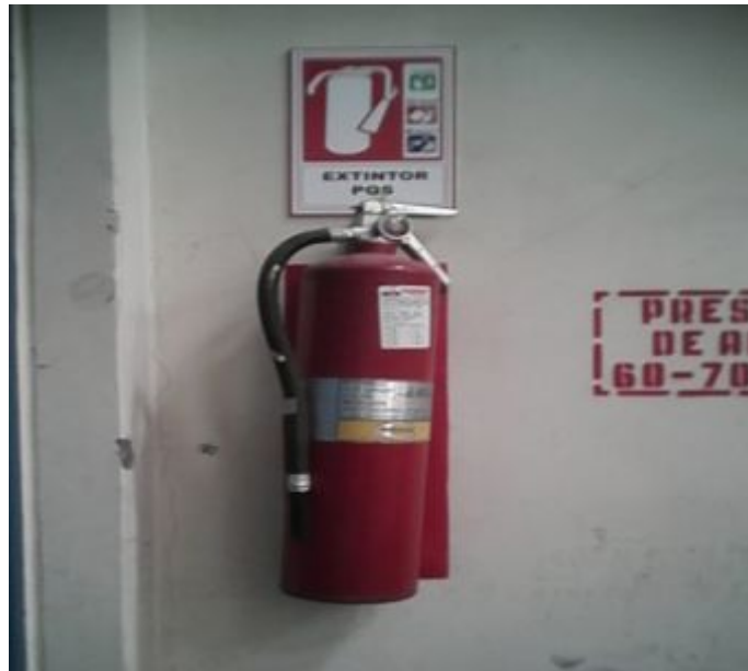
FIGURA N° 22 Extintor con sus debidas instrucciones
