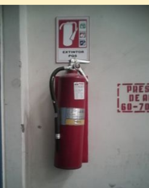
Extintor con sus debidas instrucciones
