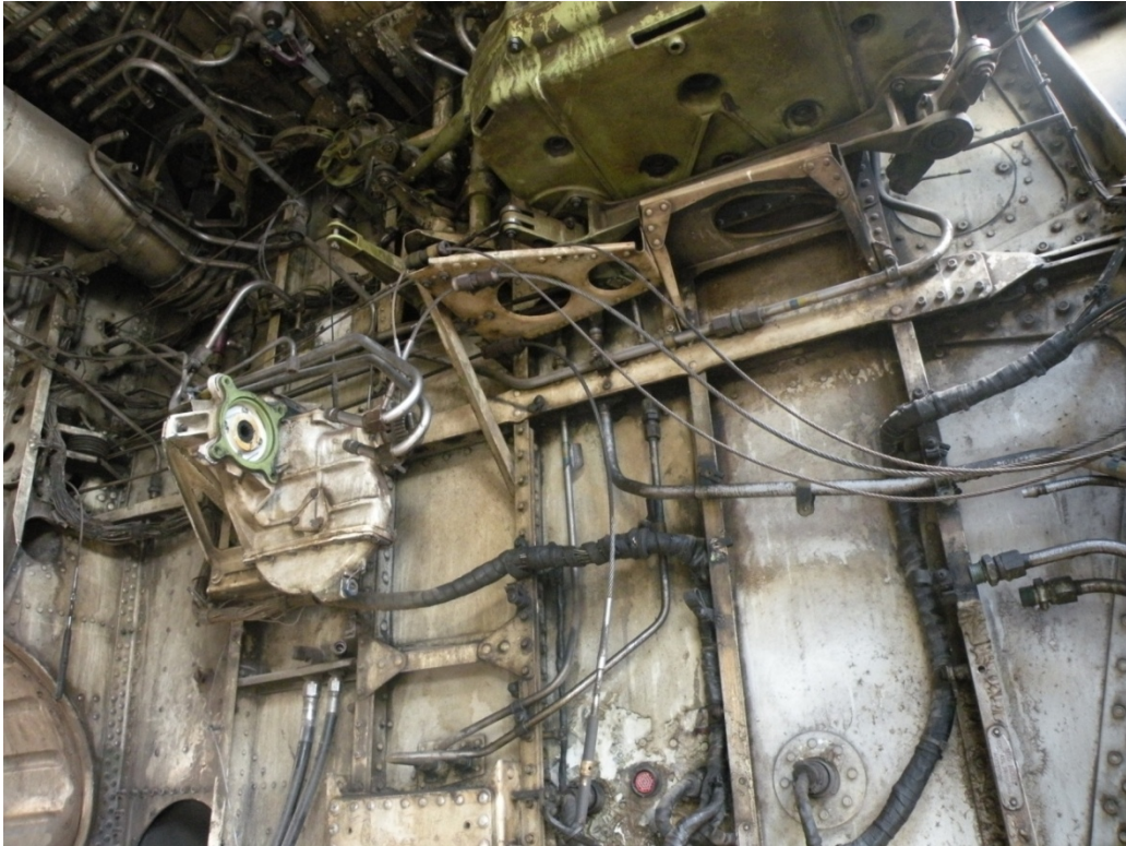
Fig. 3.7 Cables desconectados del Boeing 727
