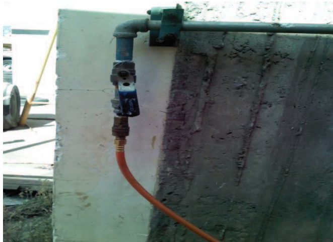
Figura 3.5. Toma de aire a utilizar en la rehabilitación.
